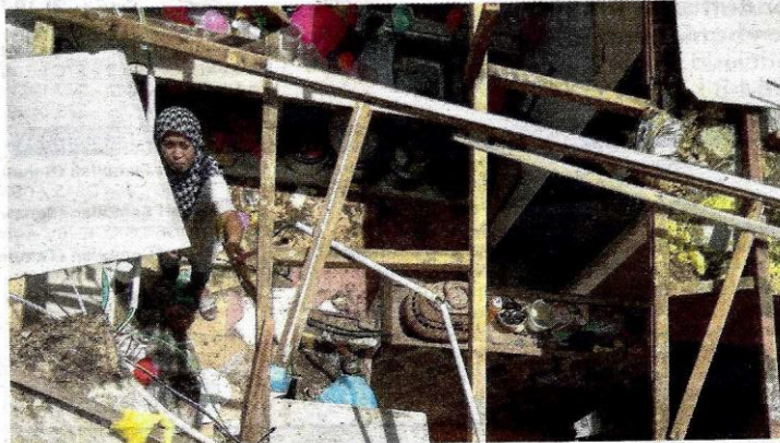
SEORANG penduduk, Nurul Kamsiah Samat melihat keadaan rumahnya yang rosak dalam kejadian ribut akibat Taufan Lekima di Pangsapuri Mutiara Idaman 1, Jelutong, Pulau Pinang pada Sabtu lalu.
